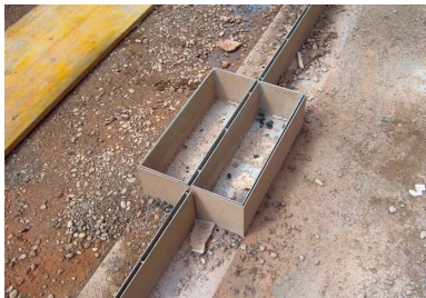
Rue de la République. Mise en place du caniveau à fente sur la plate-forme support.
