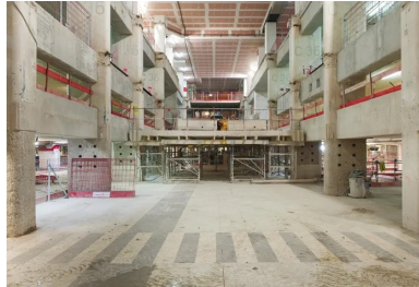
Pour permettre l'accès au chantier, une « faille » de 90 m de long, 10 m de large et 20 m de profondeur a été découpée dans les dalles des parkings existants.
