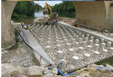
Les « menhirs » de 50 cm de diamètre et hauts de 90 cm, laissant une hauteur utile de 50 cm, sont ancrés dans un radier en béton armé. au-dessus, des enrochements secondaires disposés de façon aléatoire ont été scellés dans un bain de mortier.
