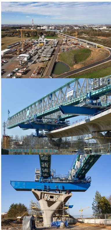
Tous les voussoirs sont préfabriqués dans une aire dédiée de 4,5 ha. Après maturation, les voussoirs sont acheminés jusqu'à leur lieu de pose en empruntant les parties de l'ouvrage déjà construites.
