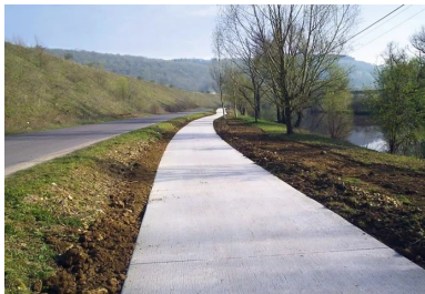
La réalisation de la piste cyclable a nécessité l'utilisation d'une Miller MI-1800 pour couler 500 mètres linéaires en moyenne par jour.
