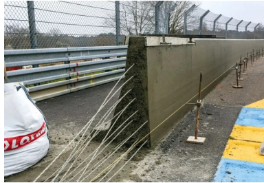
Les glissières FIA-FIM comportent 17 filants métalliques (torons).
