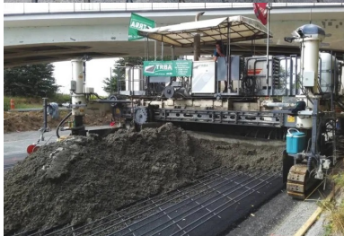
Le nu supérieur des barres longitudinales des armatures se situe entre 80 et 100 mm de la surface du revêtement.
