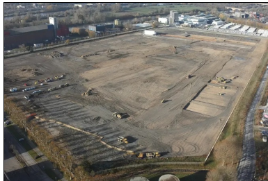
Vue générale du chantier de terrassement. Il a été conçu en circuit fermé déblais-remblais. © Medinger & Fils
