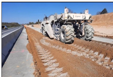
RCEA/A79 entre Montmarault (03) et Digoin (71). Eiffage Génie civil a réalisé une plateforme de haute qualité PF4 en améliorant la PST inférieure à la chaux, en renforçant la PST supérieure au liant Ligex M4 et en confectionnant une couche de forme traitée au même liant Ligex M4 de Heidelberg Materials (cf. Routes Info #18). © Eiffage
