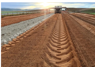
RN102 à Brioude (43). Spie Batignolles Valérian a réalisé une plateforme support de haute qualité PF3 en mettant en œuvre une couche de forme traitée à la chaux puis au liant. © Maurice Bufalo / Spie Batignolles Valérian
