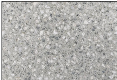
Béton érodé à Laval (détail). ©Plaine Étude
