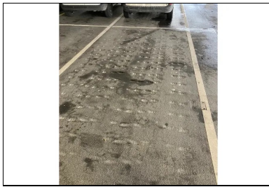
Poinçonnement de caddies de supermarché et solution composite « métal-dalles en béton ». ©Cédric Le Gouil
