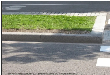
Bordure décorative en béton désactivée - Protection piste cyclable à proximité d'une voirie. © PROFIL
