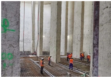
L'intérieur du bassin dévoile un volume monumental, émaillé par 32 barrettes. Ancrées à 81 m de profondeur, celles-ci garantissent la stabilité structurelle de l'ouvrage en toutes circonstances, notamment vis-à-vis des risques de soulèvement ou de basculement.
