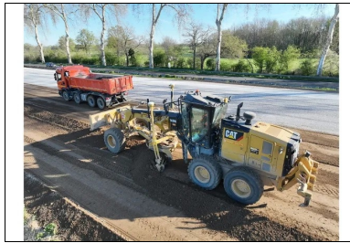
Réalisation de la couche de forme. Acheminement des matériaux B4/B5 par camion et réglage par la niveleuse. (© Roger Martin)
