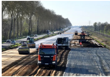
RN7. Vue générale du chantier de mise en œuvre de la couche de forme traitée au liant LV-TS 03. À gauche, l'actuelle RN7, bordée de platanes, et, à droite, la ligne SNCF Paris - Clermont-Ferrand. (© Roger Martin)
