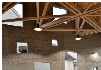
La salle résulte de l'association de deux matériaux bruts : un socle maçonné supportant une charpente en épicea massif.
