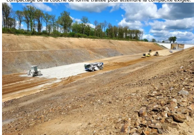
Vue générale du chantier de traitement de la couche de forme. (© Guintoli - NGE)
