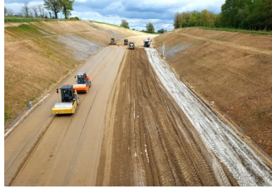
Vue générale du chantier de mise en œuvre de la couche de forme traitée au liant Rolac Premier ECOPlanet. (© Guintoli/groupe NGE)
