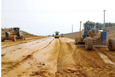
Réglage à la niveleuse pour obtenir un profil en long très régulier et atelier de compactage de la couche de forme traitée pour atteindre la compacité exigée.
