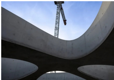
Gare Mairie-de-Vitry-sur-Seine, Agence King Kong, architectes, photo : © Eric Garault, 16Prod
