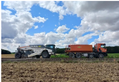
RD 119. Retraitement en place au liant hydraulique routier ROC VDS entre Briot et Briot-La-Grange. L'humidification du matériau est réalisée directement dans la cloche du malaxeur. (©Colas)
