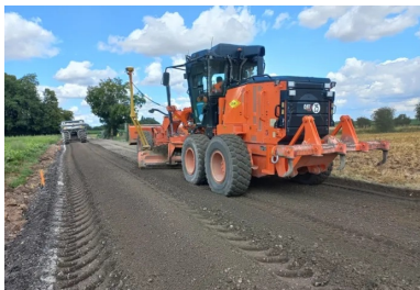
Le retraitement au LHR est suivi par un nivellement et la mise au profil du matériau. (©Colas)
