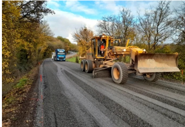
Mise en œuvre de la couche anti-remontée de fissures en grave non traitée sur une épaisseur de 8 cm. (©Ludovic Padeloup/Conseil départemental de la Vienne)
