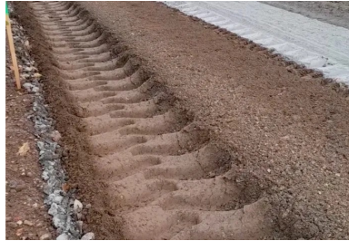
Malaxage du matériau de l'ancienne chaussée avec le liant Ligex M10 sur une profondeur de 35 cm, permettant d'obtenir un matériau homogène sur toute l'épaisseur et sur toute la largeur de la nouvelle chaussée. (© Ludovic Padeloup/Conseil départemental de la Vienne)
