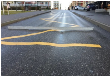
Photo 3 : arrêt de bus déformé - (c) CIMBETON
