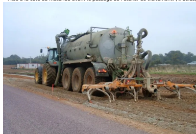
La teneur en eau du sol est ajustée à la teneur de l'optimum Proctor à l'aide d'une arroseuse-enfouisseuse. (©Colas)
