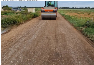
LE COMPACTAGE DU MATERIAU TRAITÉ A L'AIDE D'UN COMPACTEUR MONOBILLE LISSE VIBRANT. (© B. MONTAGNINI _ECOSTAB)
