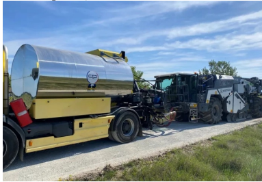
UN MALAXAGE ET LES DERNIERS AJUSTEMENTS EN TENEUR EN EAU JUSQU'A L'OBTENTION DE LA TENEUR OPTIMALE SE FONT EN INJECTION D'EAU DIRECTEMENT DANS LA CLOCHE DU PULVIMIXEUR (© JACOB GOUVENEAUX BRAJA VESIGNE)
