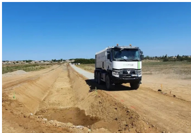
EPANDAGE DU LIANT HYDRAULIQUE ROUTIER LVT5 13 A L'AIDE D'UN EPANDEUR MODERNE STREUMASTER SW18 (COEFFICIENT LTV EST EGAL A 333). (© B. MONTAGNINI _ECOSTAB)
