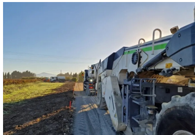
Le traitement des matériaux du site avec un liant hydraulique routier est une technique incontournable dans le cas d'aménagement d'une voie étroite. (© Bruno Montagnini_Ecostab)
