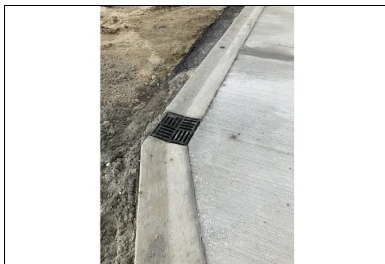
L'eau est canalisée vers des regards à grille. (© Joseph Abdo, JA-Consulting)
