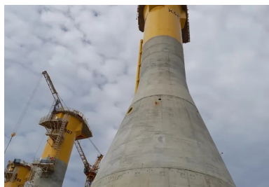
Pour assurer la stabilité des éoliennes, les fondations pèsent 5 000 t et seront remplies de 3 000 m 3 de matériaux de ballast.
