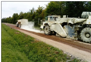
Chaussée rabotée et élargie à 6,60 m. Atelier de prétraitement en place à la chaux en action.
