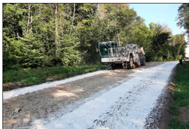
Après l'épandage du LHR, le malaxeur entre en action pour mélanger le matériau et le liant.
