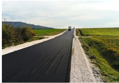
Compactage du BCS. Mise à niveau des chemins d'accès aux parcelles agricoles.
