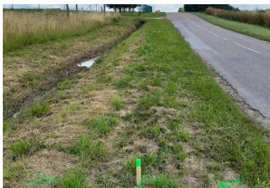
État de la chaussée avant les travaux.
