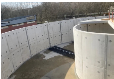
Les voiles des bassins ont été réalisés à l'aide d'un outil coffrant circulaire fabriqué sur mesure. Les rayons de courbure de chacun des bassins étant différents, le coffrage était réglé pour épouser précisément les courbes.
