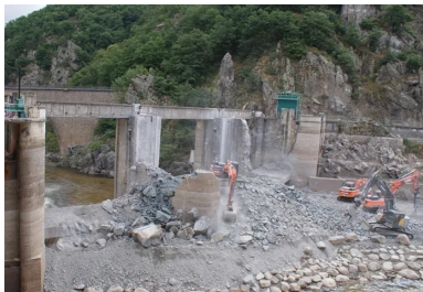
100 % du béton de la déconstruction sera transformé en granulats et réutilisé dans la future voie d'accès.
