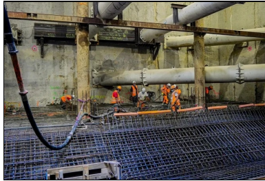
© SYTRAL (MOA) Bétonnage du radier. Les parois moullées sont maintenues par des butons.
