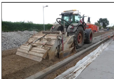
Après épandage du liant, le malaxeur mélange intimement le liant et les matériaux de l'ancienne chaussée.
