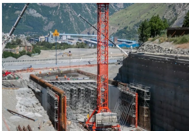
Les traverses supérieures de la tranchée couverte sont coulées en place à partir de tours d'étalement.
