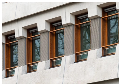
Le béton brut et les menuiseries donnent une apparence domestique aux façades renouvelées, dont le dessin est conservé.
