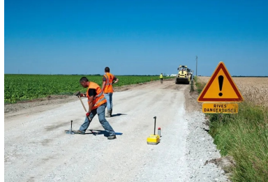
Contrôle de la compacité et de la teneur en eau de la chaussée à l'aide d'un gammadensimètre.
