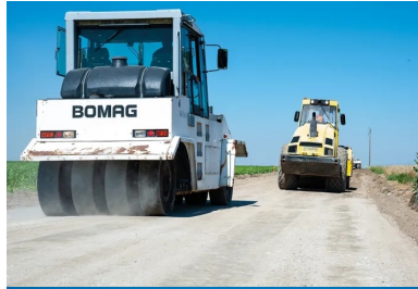
L'atelier de compactage composé d'un compacteur à pneumatiques Bomag BW 24 RH et d'un rouleau V5.
