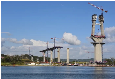
Le chantier comprenait la construction de 4,6 km d'ouvrages à 2 x 2 voies, dont 3,1 km d'ouvrages exceptionnels.
