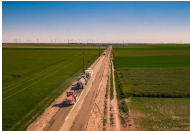
L'atelier de retraitement en action. Les bandes d'élargissement sont visibles de part et d'autre de la chaussée.
