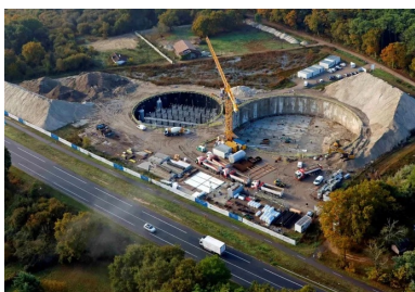
Les travaux de terrassement à l'intérieur des cylindres ont pu être menés une fois l'enceinte étanche achevée.
