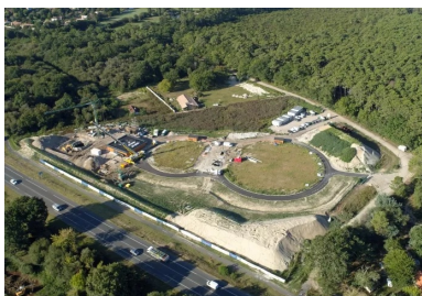
Implantés à quelques mètres de la départementale, les deux bassins enterrés, recouverts d'herbe, sont totalement invisibles. un talutage sépare le site d'avec la route.
