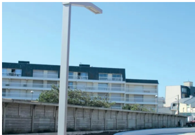
L'éclairage public a été entièrement repensé avec l'utilisation de diodes électroluminescentes (LED).
