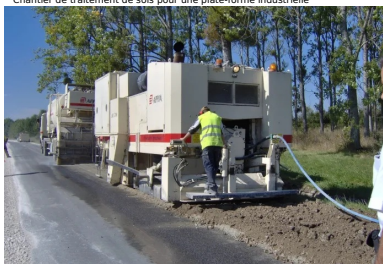
Vue générale d'un chantier de retraitement d'une chaussée en place avec un liant hydraulique routier
