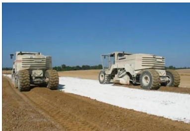
Traitement des sols - Un malaxeur mélange le liant hydraulique routier avec le sol
