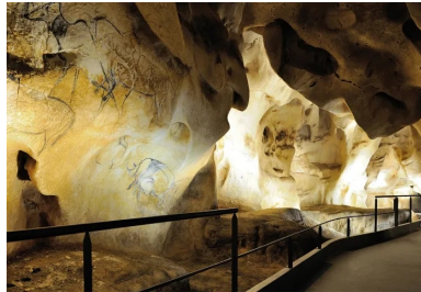
À l'intérieur, des centaines d'armatures ont été soudées à la main pour recevoir un béton projeté puis un mortier paysager.
