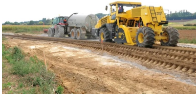
Derrière le malaxeur Bomag R5 650, un technicien vérifie visuellement l'homogénéité du mélange entre le matériau de l'ancienne chaussée et le liant hydraulique.
