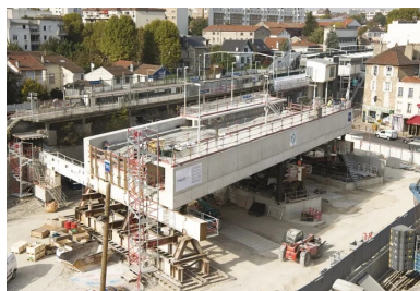
Pont-dalle à Arcueil - Cachan. Après le coulage et quelques jours avant le ripage.
