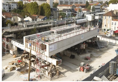
Avancée du chantier à Arcueil - Cachan avec mise en place du pont-dalle.
