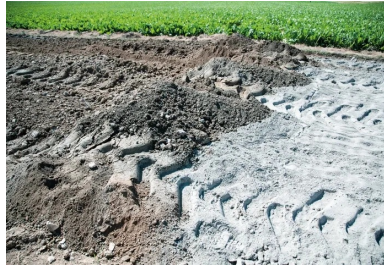
Résultat à l'issue du malaxage : le liant clair a été finement mélangé avec le matériau de l'ancienne chaussée.
